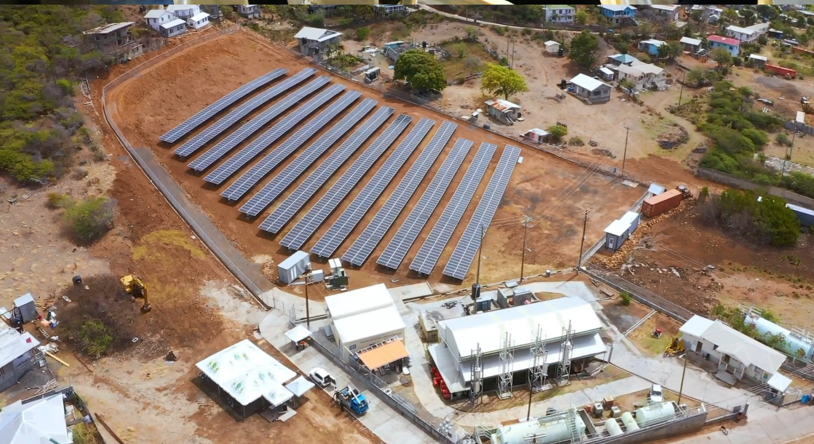
محطة لإنتاج الطاقة الشمسية الكهروضوئية بقدرة 600 كيلوواط في جزر سانت فينسنت وغرينادين، مزودة بنظام بطارية ليثيوم أيونية بقدرة 637 كيلوواط/ساعة. المصدر: شركة أبوظبي لطاقة المستقبل "مصدر"
