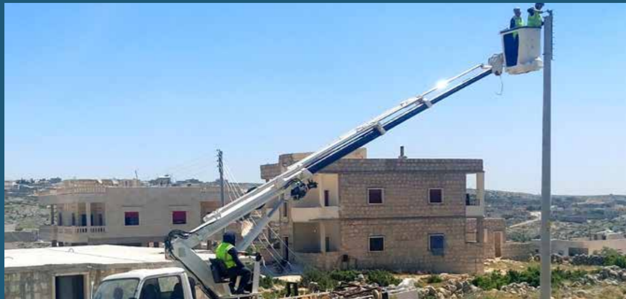
إعادة تأهيل وتوسعة نطاق شبكة الكهرباء بإحدى قرى محافظة حلب. أحد المشاريع التي دعمتها الإمارات من خلال صندوق الائتمان لإعادة إعمار سوريا.
